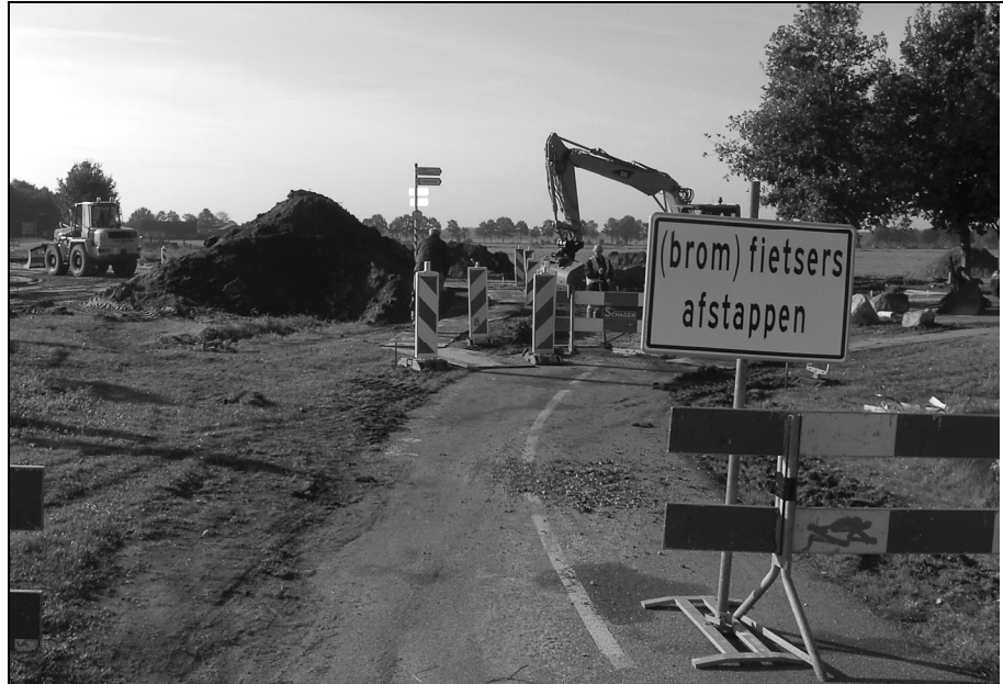
Afbeelding 3.11. Locatie waar onveilige situaties kunnen ontstaan doordat fietsers vlak langs het werkvak fietsen, namelijk links ervan over de platen.
