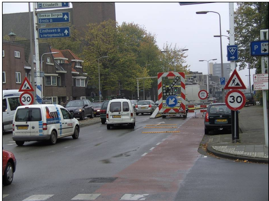
Afbeelding 3.7. Verkeerd beginpunt van een barrier.
