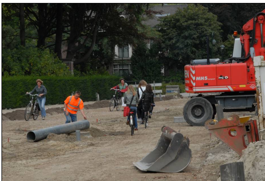
Afbeelding 3.10. Locatie waarbij onveilige situaties kunnen ontstaan doordat fietsers door het werkvak fietsen.
