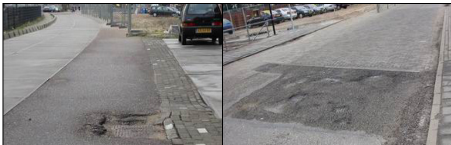
Afbeelding 3.10. Gevaarlijk wegdek voor GTW's.
