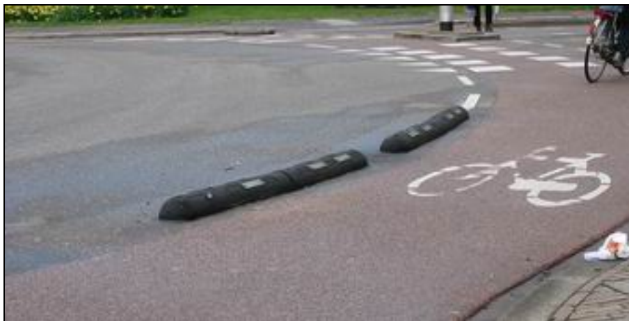
Afbeelding 3.9. Afscheiding fietsstrook en hoofdrijbaan op een rotonde met een voor GTW's gevaarlijke opstaande rand.
